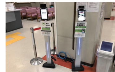
正面玄関(サーモグラフィ)
